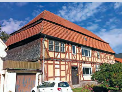
Feststellung von Mängeln (oben) und Zustand 2013
