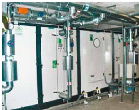
Lüftungs- anlage im Museum für angewandte Kunst
