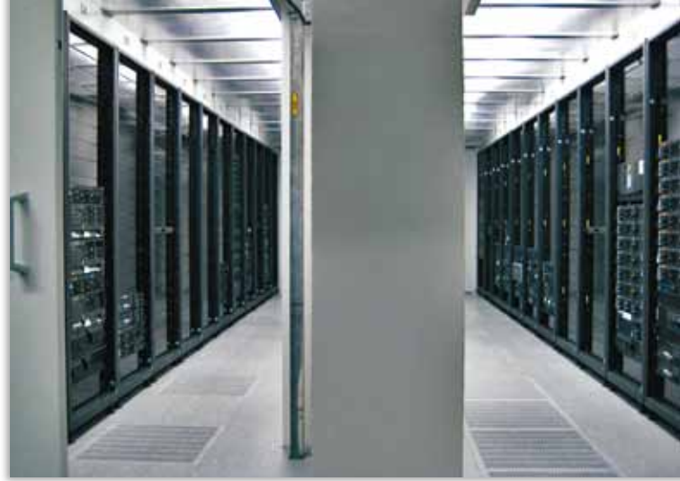
Kaltgangeinhausung im Rechenzentrum der LECOS GmbH
