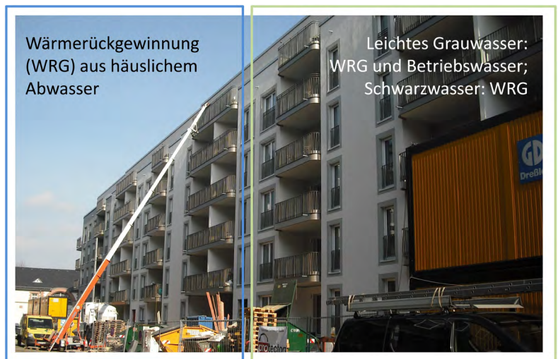
Ansicht des im Bau befindlichen Wohnblocks mit Beschreibung, wie Wärmerückgewinnung und Grauwasserverwertung in den jeweiligen Gebäudehälften implementiert werden. Das Betriebswasser wird für die Toilettenspülung genutzt.
