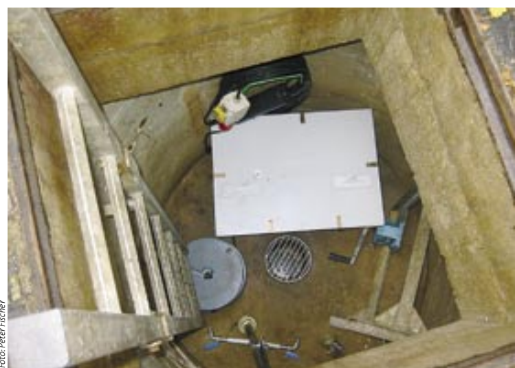
Geöffneter Notbrunnenschacht mit eingelagerter Ausrüstung (Vorsorge führt im Krisenfall zur Schadensminderung).
