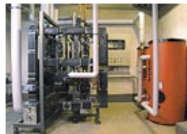
Die SEZ (Solare EnergieZentrale)
