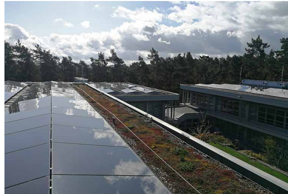
PV-Anlage mit extensiver Begrünung auf dem LVR-Freilichtmuseum Kommern
