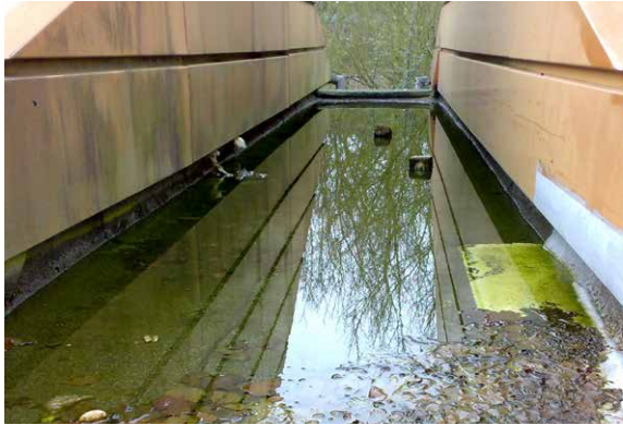
Dachzustand vor Sanierung
