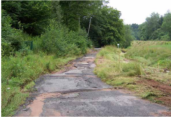
Überflutungsschäden an Wegen
